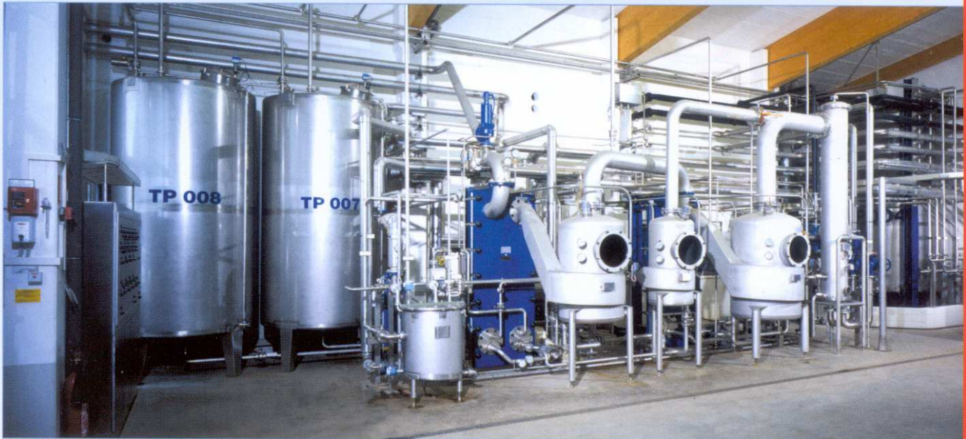
2-stufige Eindampfung mit integrierter Tiefenentkeimung
