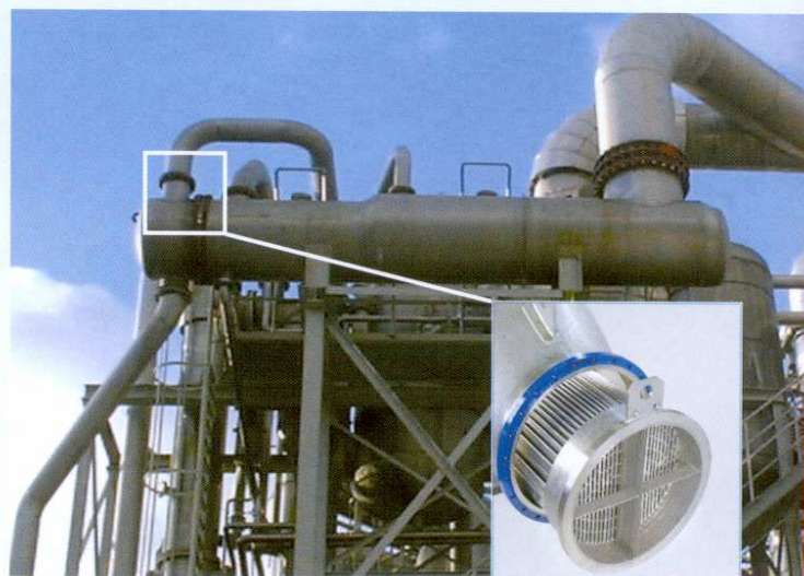
Oberflächenkondensator in Flachrohrausführung in einer sulfatablaugen-Eindampfanlage.
